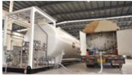
LNG 加气站调试中
